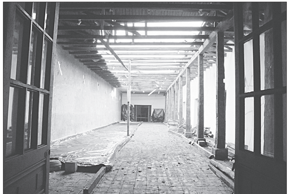
El 27/F generó graves daños.
